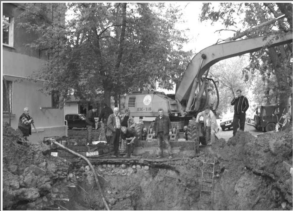
Сотрудники МУП «ЖКХ» ликвидируют аварию на ул. Люблинской
