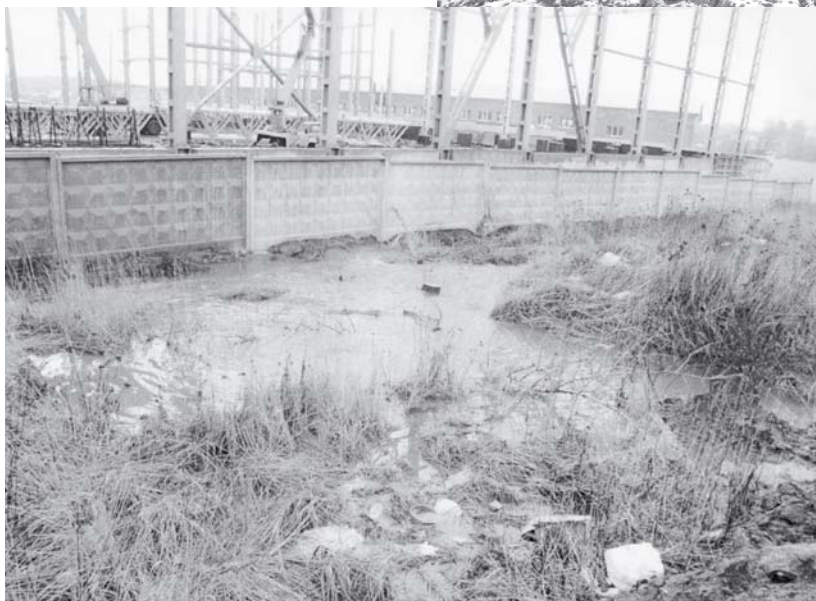
Место аварии на напорном коллекторе. Фото 13 марта 2008 г.
